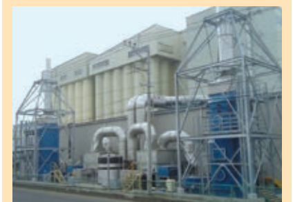
●悪臭防止法に適合した脱臭装置の導入
