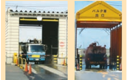
●工場入出門の車両消毒設備の設置
