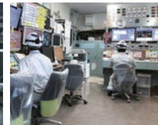
工場内 FAシステム中央操作室
