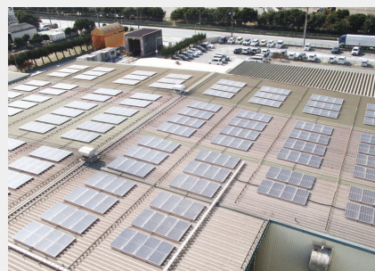
鹿島工場に設置された太陽光パネル
